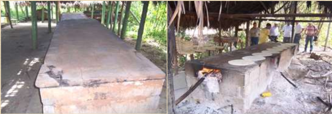
Hornos antes usados. Observe el deterioro
