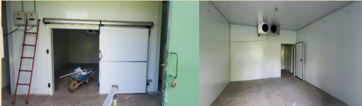
Cuarto frío en la estación de Constanza
